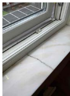
Bildet viser sprekk i vindusbrett.
