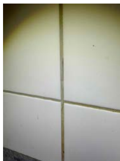
Bildet viser spekk/riss i flisfuge.
