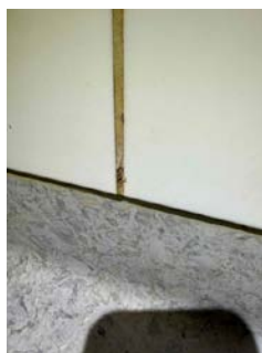
Bildet viser spekk/riss i flisfuge.
