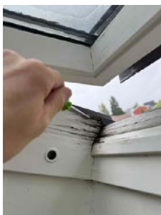
Bildet viser takvindu med råteskade.
