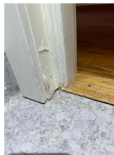
Bildet viser svelling/fuktskade på foringen til baderomsdøren.
