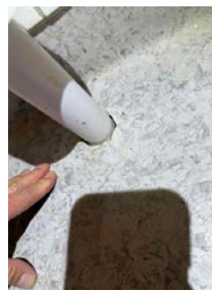
Bildet viser avløpsrøret fra servanten.
