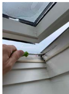
Bildet viser takvindu med råteskade.
