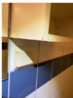
Bildet viser svelling på baderomsinnredning.
