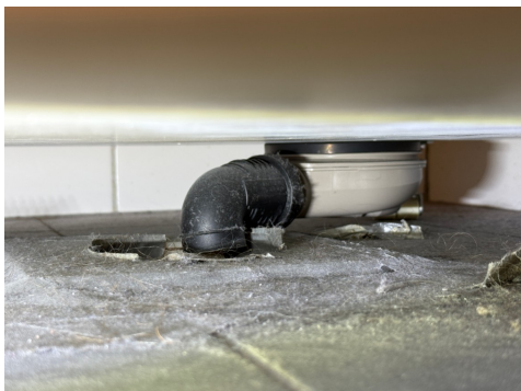
Sluk under dusjkabinett.
