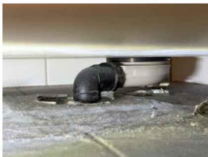
Sluk under dusjkabinett.
