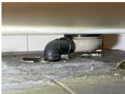
Sluk under dusjkabinett.
