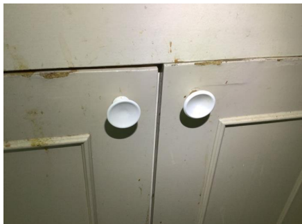
Eksempel på skapdører med skader.
