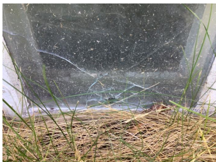
Sprukket glass i vindu.
