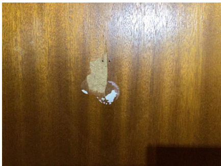
Eksempel på skade på dør.
