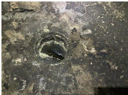
Plastsluk i betonggulv.
