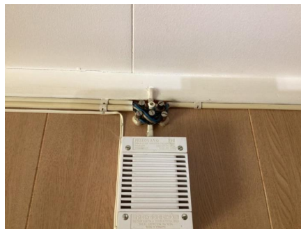
Manglende deksel på koblingsboks.
