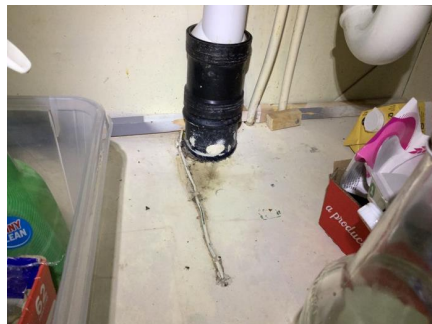
Det ligger noe vann på bunnplate under avløpsrør.
