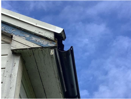
Endelokk mangler på takrenne.
