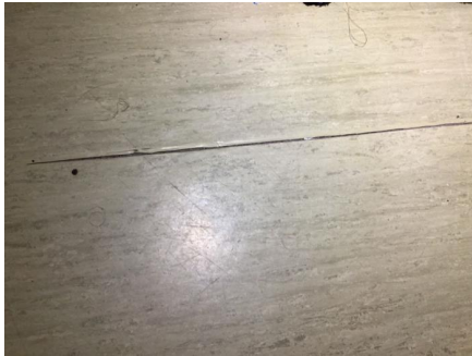
Glippe i sveiseskjøt i vinylbelegg.
