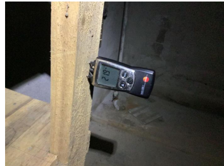
Skadelig fuktinnhold i treverk.
