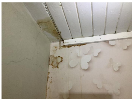
Fuktskjolder ved pipe.
