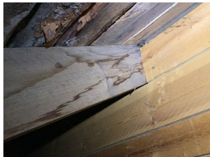
Fuktskjolder på taksperre.
