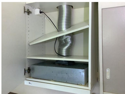
Kjøkkenventilatoren virket ikke på befaringsdagen.
