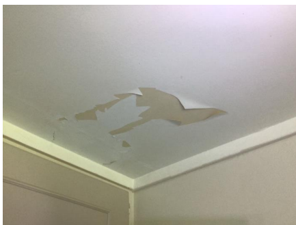
Løsnet folie på himlingsplate.
