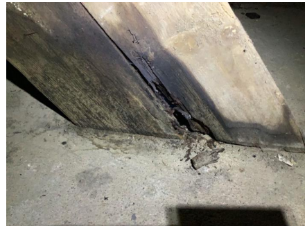
Råteskadet vange på trapp.
