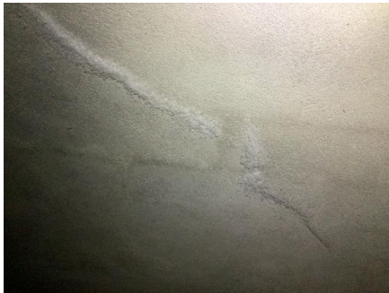
Saltutslag på grunnmur.
