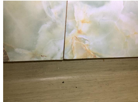
Tegn til svelling i nedkant av baderomsplate.
