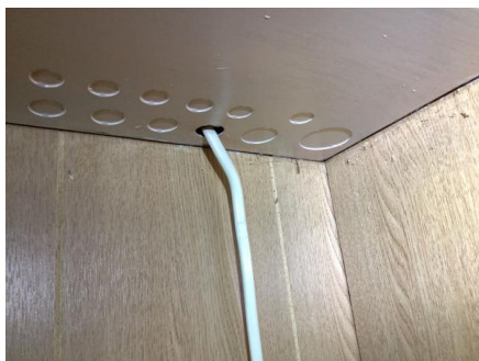
Utett innføring i sikringsskap.
