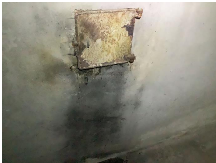
Sotvann under sotluke.
