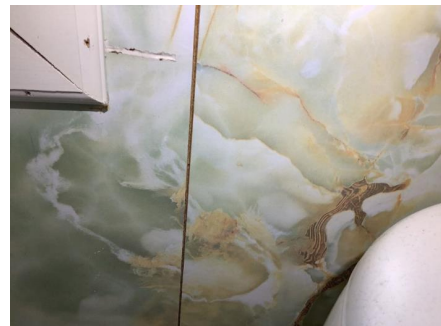
Glippe i skjøt mellom baderomsplater.
