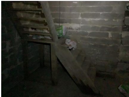
Trapp mangler rekkverk.
