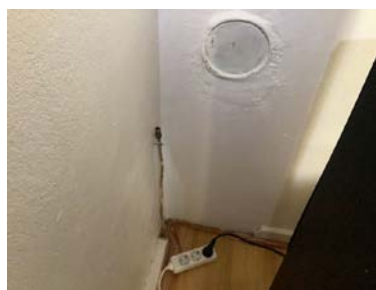
Røropplegg ved pipe.
