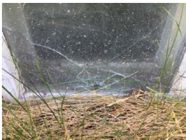
Sprukket glass i vindu.
