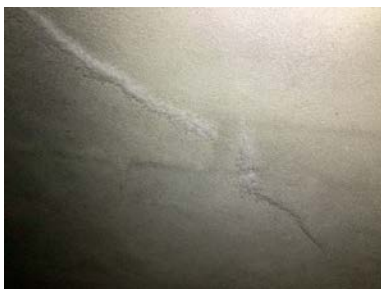
Saltutslag på grunnmur.
