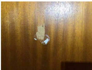
Eksempel på skade på dør.
