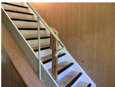
Tretrapp med stor åpning i rekkverk.
