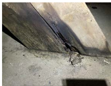
Råteskadet vange på trapp.
