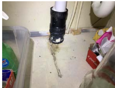
Det ligger noe vann på bunnplate under avløpsrør.
