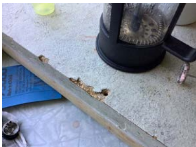
Eksempel på benkeplate med skader.
