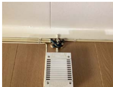
Manglende deksel på koblingsboks.
