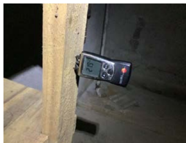
Skadelig fuktinnhold i treverk.
