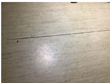
Glippe i sveiseskjøt i vinylbelegg.
