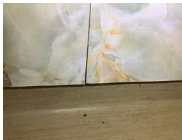
Tegn til svelling i nedkant av baderomsplate.
