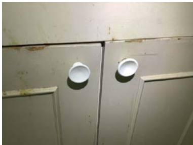
Eksempel på skapdører med skader.
