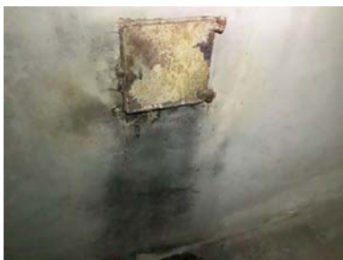
Sotvann under sotluke.
