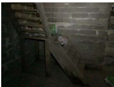
Trapp mangler rekkverk.
