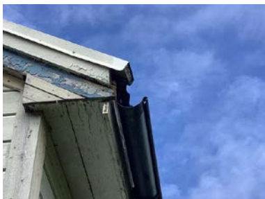
Endeløkk mangler på takrenne.
