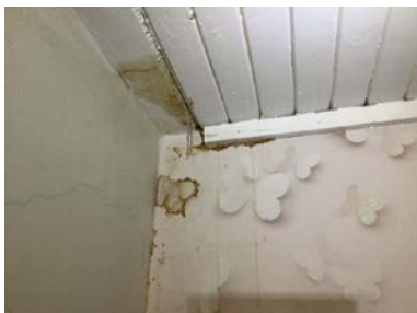
Fuktskjolder ved pipe.
