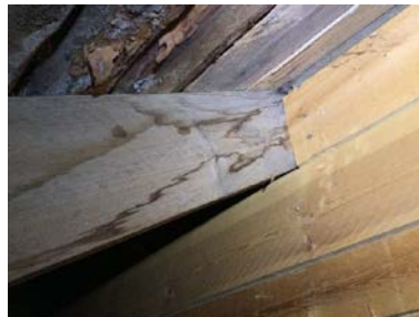
Fuktskjolder på takspærre.
