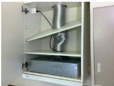
Kjøkkenventilatoren virket ikke på befaringsdagen.
