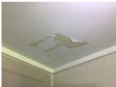
Løsnet folie på himlingsplate.
