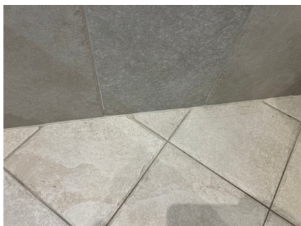
Fliser med riss (hår-riss).
