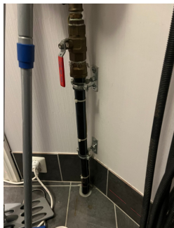
Vanninntak og stoppekran i vaskerom.
