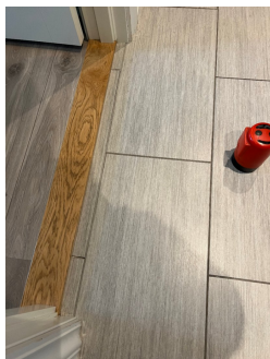
Sokkel/Hybel: Flis mot soveromsdør mangler noe fug, og er noe løs.
