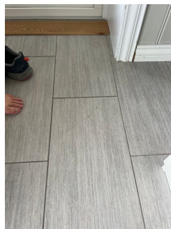
Sokkel/hybel: Sprekker i gulvflis mot terrassedør.
