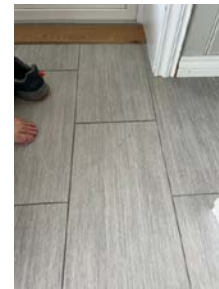
Sokkel/hybel: Sprekker i gulvflis mot terrassedør.
