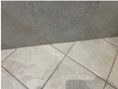
Fliser med riss (hår-riss).
