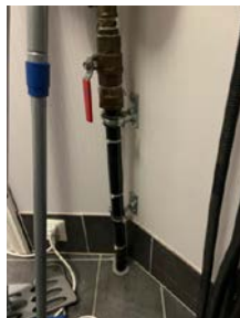
Vanninntak og stoppekran i vaskerom.
