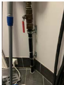
Vanninntak og stoppekran i vaskerom.
