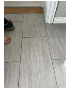
Sokkel/hybel: Sprekker i gulvflis mot terrassedør.
