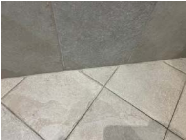
Fliser med riss (hår-riss).
