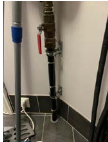
Vanninntak og stoppekran i vaskerom.
