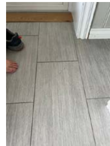
Sokkel/hybel: Sprekker i gulvflis mot terrassedør.
