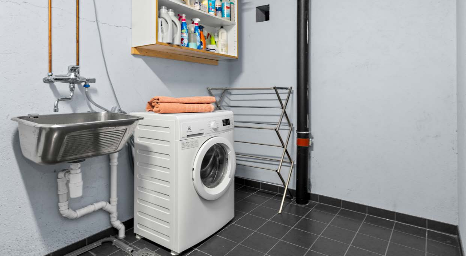
Et praktisk vaskerom med varmekabler i gulvet, utslagsvask opplegg for vaskemaskin.
