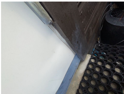
Tydelig fuktsvelling i hjørne av inngangsdør.
