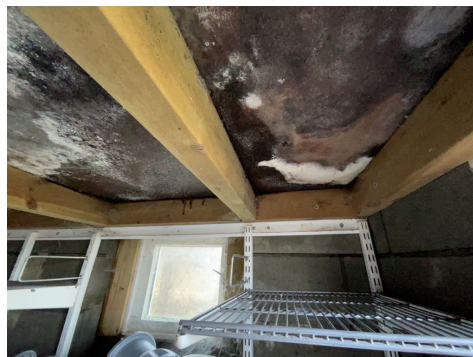
Fuktskade og muggsopp i himling i bod under terrasse.
