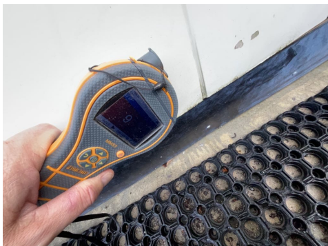
Indikasjoner på fukt i nedre del av dørblad.
