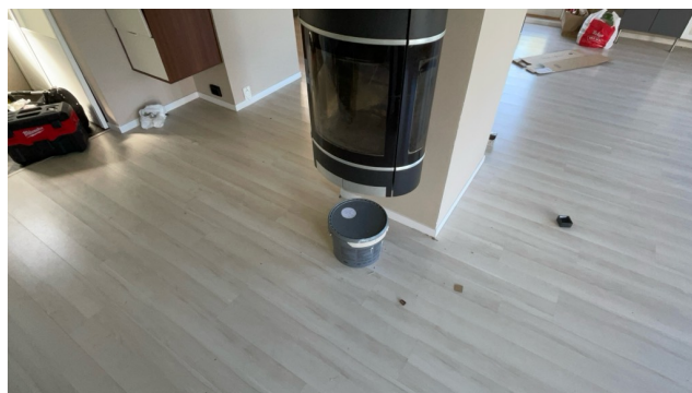
Det er ikke montert ildfast underlag på gulv under ovn i stue.
