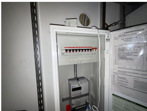
Sikringsskap. Delvis utilgjengelig grunnet redusert tilkomst på befaringsdagen.
