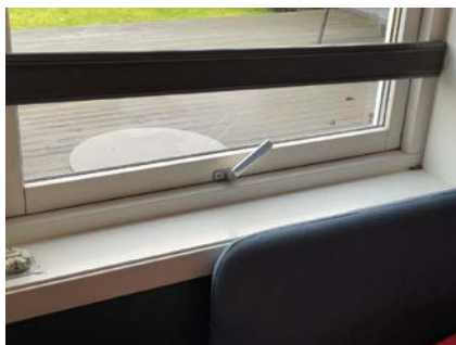
Vrider til vindu i soverom er stri og vindu kan ikke lukkes.
