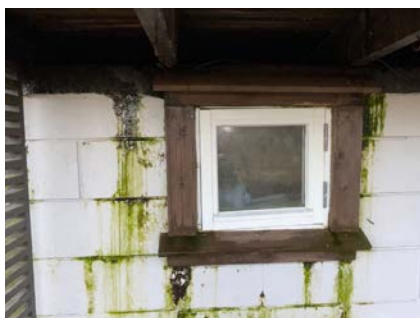
vindu i bod under terrasse er skjevt og har fuktskader.
