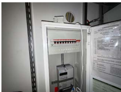
Sikringsskap. Delvis utilgjengelig grunnet redusert tilkomst på befaringsdagen.
