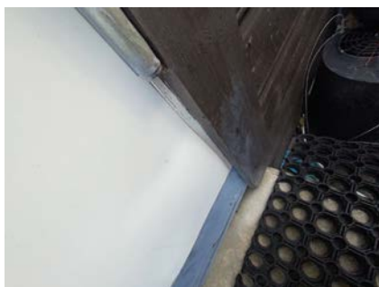
Tydelig fuktsvelling i hjørne av inngangsdør.
