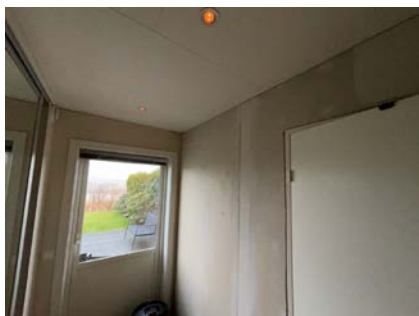
Vegg mangler overflatebehandling/maling.
