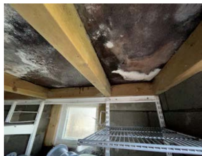
Fuktskade og muggsopp i himling i bod under terrasse.
