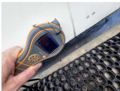
Indikasjoner på fukt i nedre del av dørbord.
