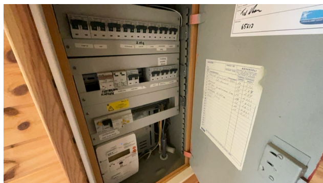
Skap er plassert i gang loft.
