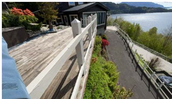
Bilde viser rekkverk med store åpninger, og stor fallhøyde utenfor.
