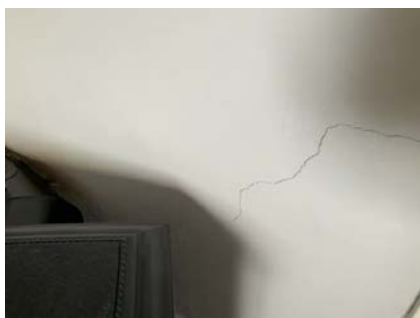
Sprekk i brannmur
