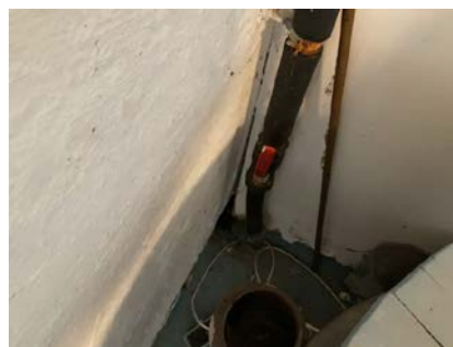
Stoppekraner i felles kjellerbod.
