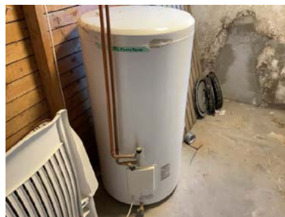
Varmtvannstank montert i bod i kjeller
