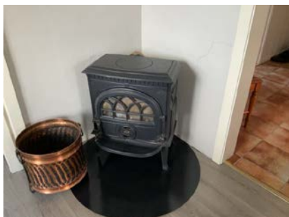
Vedovn i stue. Sprekk i brannmur.
