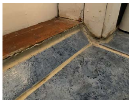
Sprekk i fuge ved utforing mot terskel.
