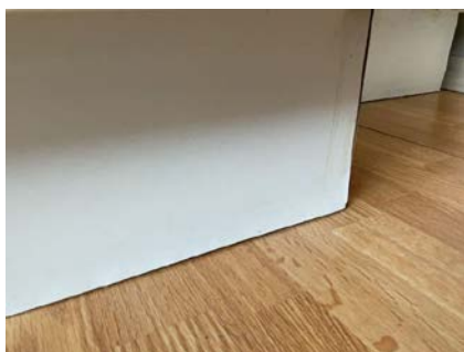
Sokkel er noe utsvelt i nedkant.
