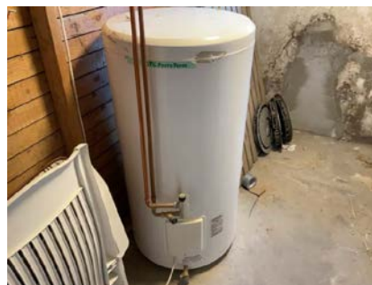
Varmtvannstank montert i bod i kjeller
