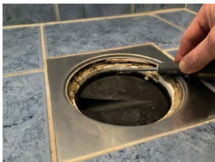
Litt synlig membran under klemring.
