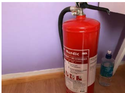
Brannslukker i trappegang
