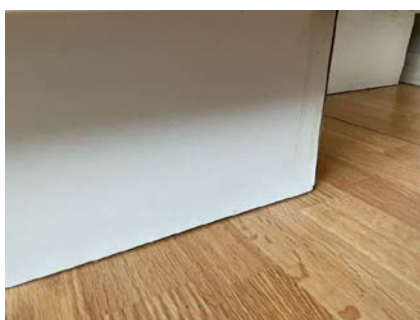
Sokkel er noe utsvelt i nedkant.
