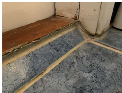
Sprekk i fuge ved utforing mot terskel.
