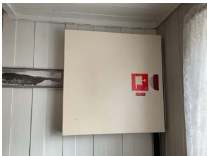
Brannslange i felles trappegang
