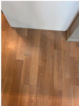
Fuktskjolder i parkett ved ende av kjøkken
