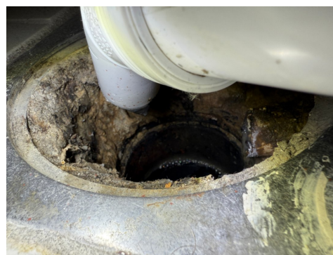
Sluk under dusjkabinett
