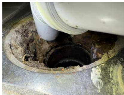
Sluk under dusjkabinett
