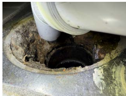
Sluk under dusjkabinett
