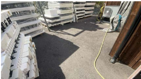
Frastående fall fra bolig og asfaltert helt opp til trepanel på vegg
