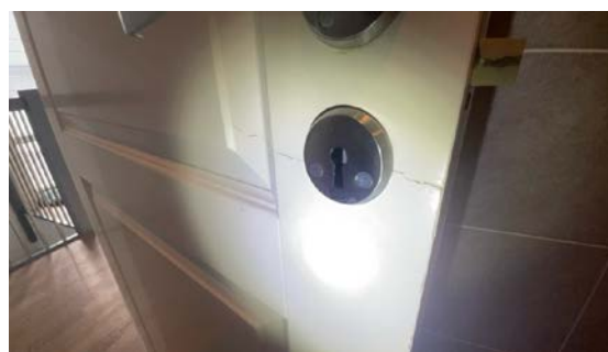
Sprekk ved låsekasse
