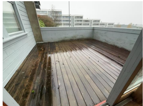
Rekkverk er 76 cm og tilfredsstillende ikke krav til høyde
