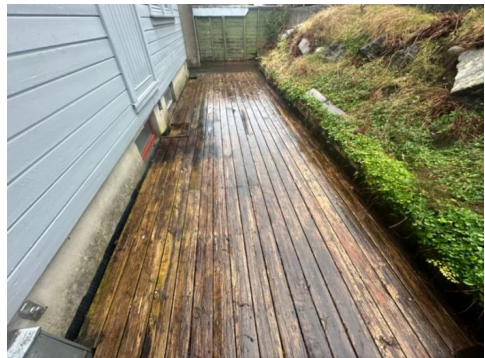
Overflater på terrasse er slitt og bør skiftes. Underliggende bjelker må da vurderes og eventuelt skiftes.
