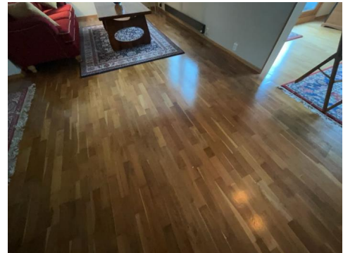
Det er godt synlige spor etter sliping av parkett i 1. etasje.
