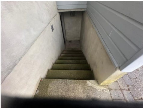
Håndløpere er ikke montert.
