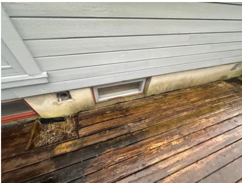
Det er ikke musetetting der dette er kontrollert.
