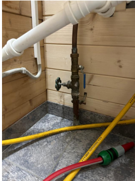
Hovedstoppekran er montert i vaskerom i kjeller.
