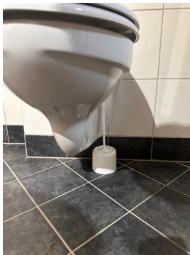
Ingen lekkasjevarsler fra innebygget cisterne.
