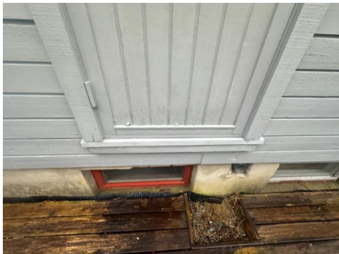
Slitt balkongdør ut fra kjøkken.
