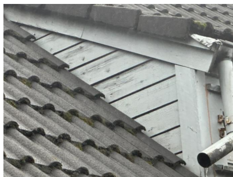
Råteskader i kledning.
