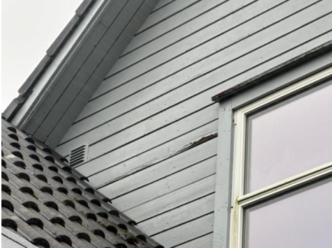
Råteskader i kledning.
