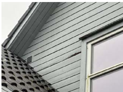
Råteskader i kledning.
