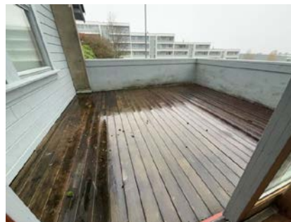
Rekkverk er 76 cm og tilfredsstillende ikke krav til høyde
