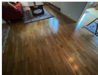
Det er godt synlige spor etter sliping av parkett i 1. etasje.
