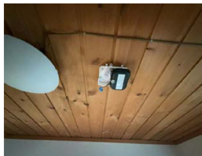
Røykvarsler i 2. etasje var demontert ved befaringen.
