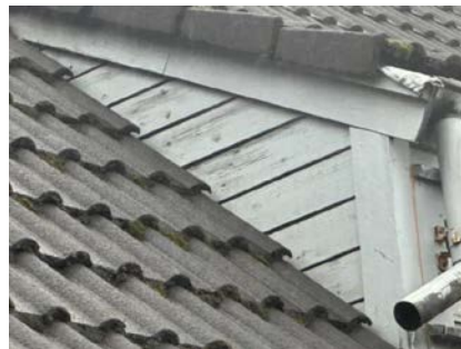
Råteskader i kledning.
