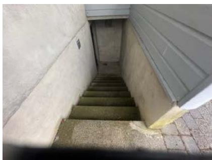
Håndløpere er ikke montert.
