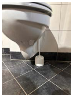
Ingen lekkasjevarsler fra innebygget cisterne.
