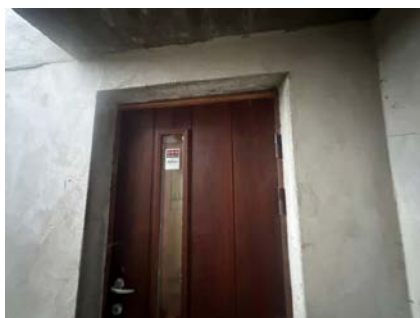
Normalt slitt entrédør og kjellerdør.
