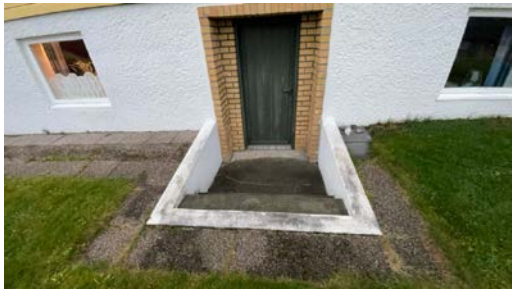
Det bør monteres sikring med rekkverk på hver side av trapp for å hindre evt. personskade
