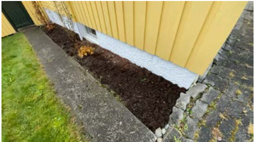
Ingen synlig grunnmursplast på øvre hjørne av boligen
