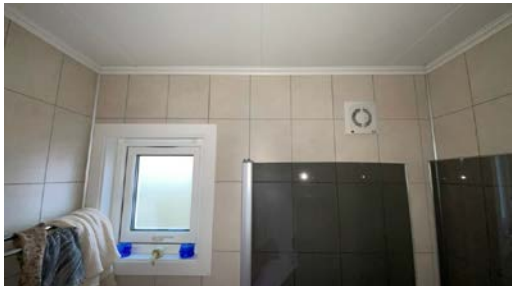
Mekanisk avtrekk på vegg og åpningsvindu
