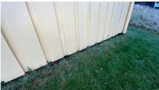
Kledning er nærme terreng, det bør etableres større avstand
