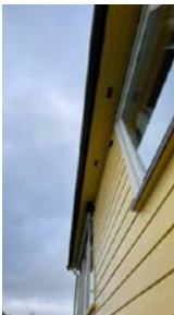
Synlige luftespalter i raftekasse ved overgang tak/vegg
