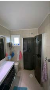
Vindu er plassert i våtsone utenfor dusjvegg
