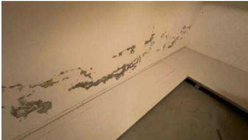
Saltutslag på vegg i bod 3
