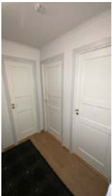
Dør til bod/kott, soverom og trapperom. Dør til bod og trapperom tar litt i karm
