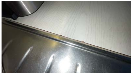
Noe slitasje på benkeplate
