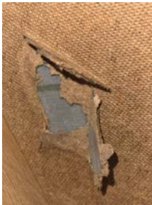
Det er synlig tett plast undertak over trefiberplater ved skade i undertak.
