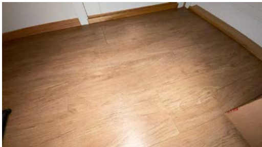
Skjøt på vinylklikk i gang er presset noe opp.
