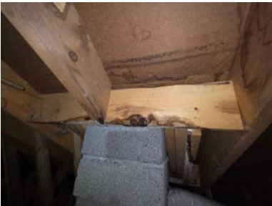
Synlige eldre fuktmerker på undertak av trefiber, ingen fukt på befaringsdagen. Plast undertak over må være montert ifb. montering av takstein
