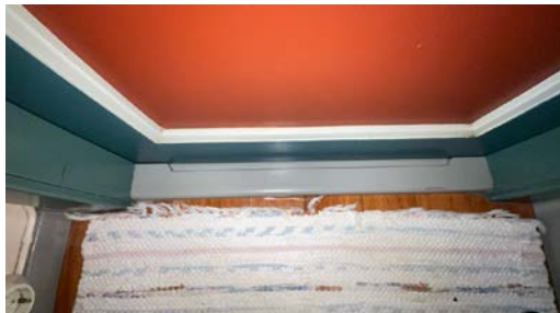
Tilluftsspalte under dør er for liten
