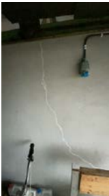
Eldre sprekk i puss som synlig i garasjen som er tettet. Ingen antydninger til bevegelser etter tetting
