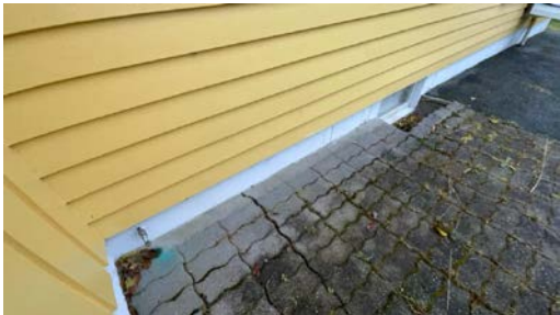
Ingen synlig grunnmursplast på oversiden av boligen
