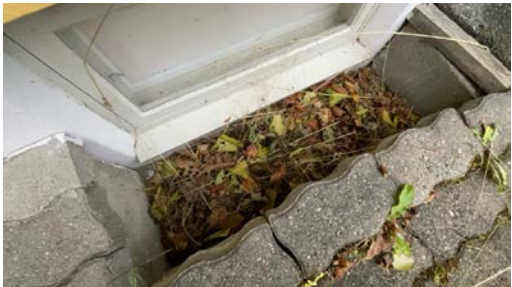
Ingen synlig grunnmursplast på oversiden av boligen i lysgrav
