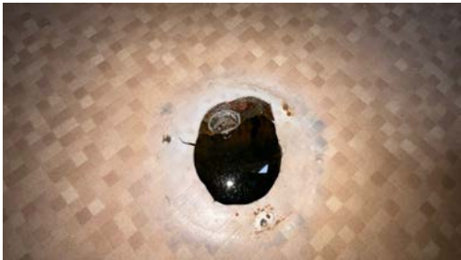
Belegg er ikke klemt mot sluk ved befaringen. Slukrist er skrudd og Oversikt klemmer belegg.
