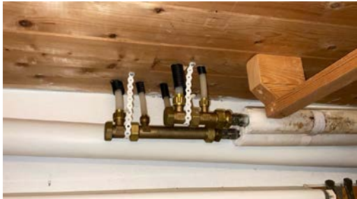
Fordelingskolber plassert på vegg
