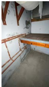
Saltutslag på vegg i garasje mot terreng
