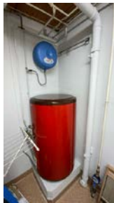
Varmtvannstank med ekspansjonskar på vegg
