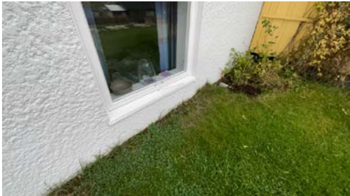
Ingen synlig grunnmursplast på forsiden av boligen
