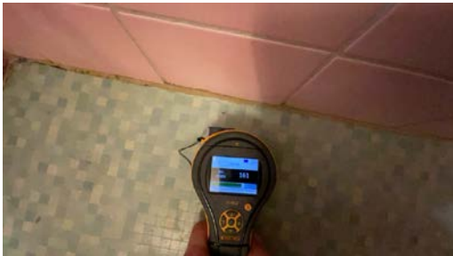
Fuktsøk er utført på gulv i dusj. Ingen forhøyde fuktavvik er målt
