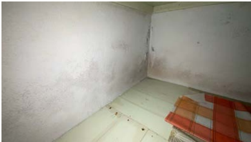
Saltutslag på vegg i bod 2
