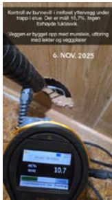
Kontroll av innforet yttervegg under trapp i stue. Det er målt 10,7%. Veggene er bygget opp med murstein, utlekting og plater.
