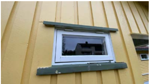
Sprekk i glass på bod ved inngang
