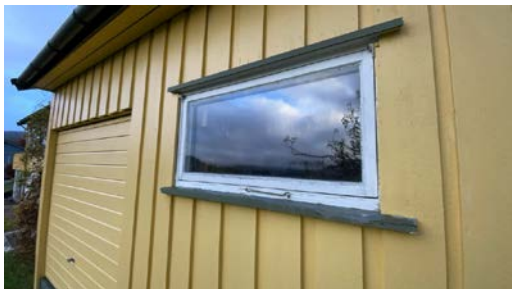
Noe overflateslitasje på vindu
