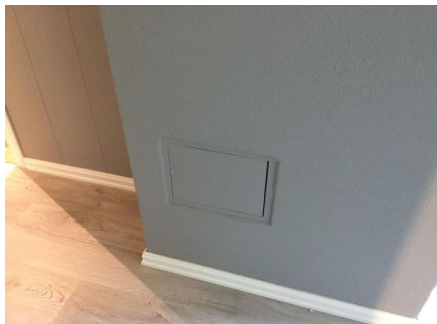
Sotluke plassert på stue.
