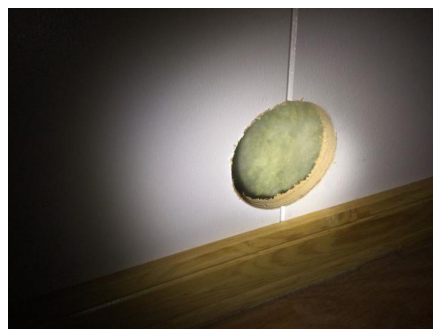
Det er observert avvik i oppbygningen av ytterveggene mot terreng (plast i vegg under terreng). Denne konstruksjonen er ikke tillatt i dag på grunn av stor risiko for skader.
