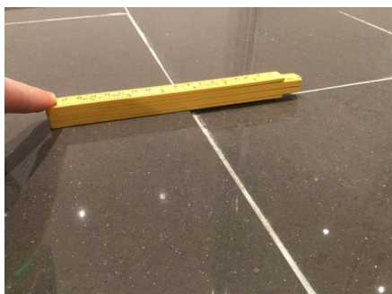
Høydeforskjell på fliser.
