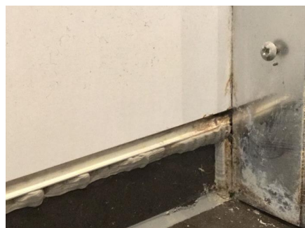
Ufagmessig fuging flere steder.
