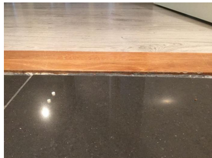
Ingen synlig oppbrett av membran ved terskel.
