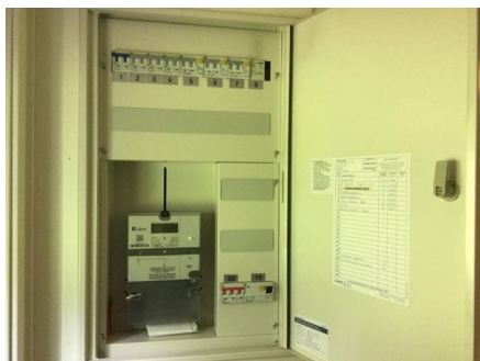
Sikringskap plassert i entrè.
