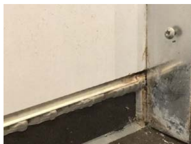
Ufagmessig fuging flere steder.
