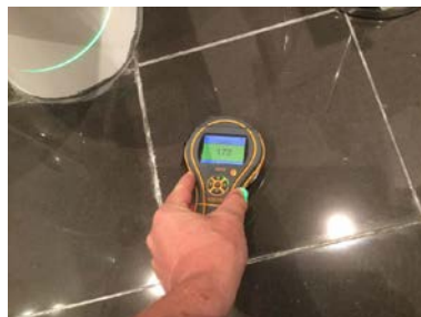
Med enkle fuksøk ble det ikke registrert unormale verdier.
