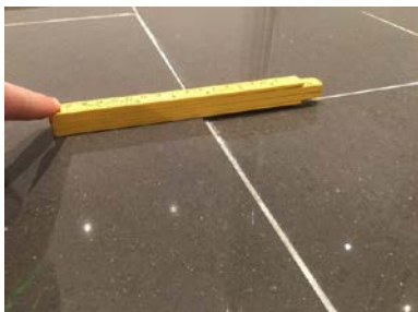
Høydeforskjell på fliser.
