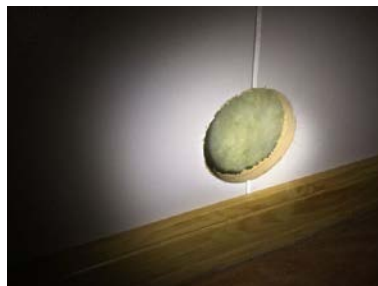
Det er observert avvik i oppbygningen av ytterveggene mot terreng (plast i vegg under terreng). Denne konstruksjonen er ikke tillatt i dag på grunn av stor risiko for skader.
