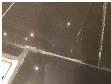
Misfarging på fuger.
