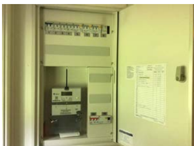
Sikringsskap plassert i entré.
