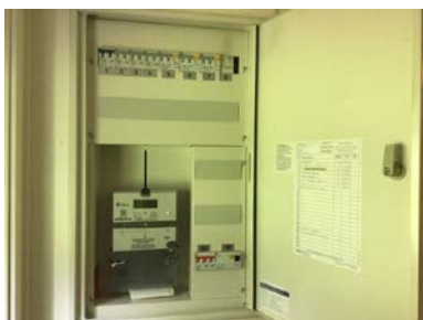
Sikringsskap plassert i entrè.
