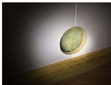
Det er observert avvik i oppbygningen av ytterveggene mot terreng (plast i vegg under terreng). Denne konstruksjonen er ikke tillatt i dag på grunn av stor risiko for skader.
