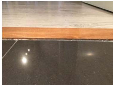
Ingen synlig oppbrett av membran ved terskel.
