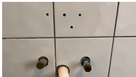
Det er registrert utette rørgjennomføringer i vegg
