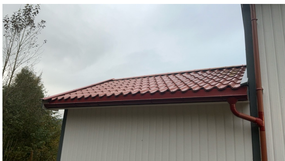
Det mangler snøfangere på tilbygg.
