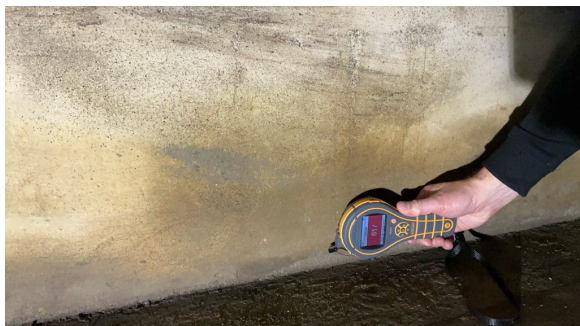
Fuktutslag på betongvegg
