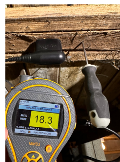
Registrert litt fuktighet samt råte i bjelkelag
