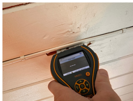
Malingflass i spisestuetak, ingen fukt.
