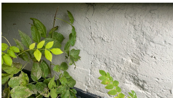
Riss/sprekke i mur
