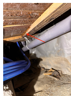
Bilde tatt inn i krypkjeller fra luken. Mulig fuktighet på bjelke?
