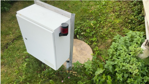
Renseanlegg under baken med tilkoblet El-skap
