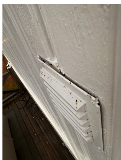
Ventil som ikke ligger inntil kledning
