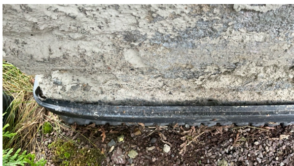
Løs list og mangelfull tetting
