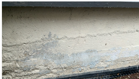
Riss i mur
