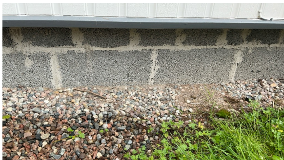
Lecablokker bør pusses
