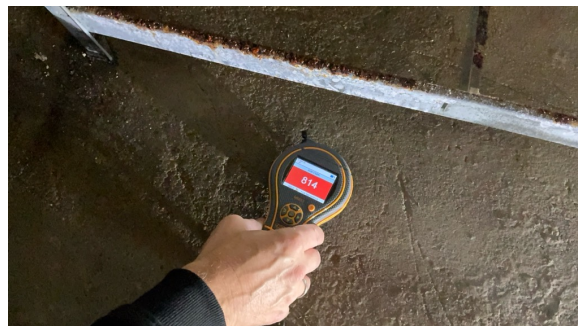
Fuktutslag på kjellergulv
