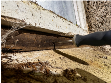
Vindu (2) har tørket råteskade på innsiden av karmen.
