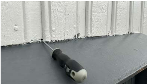
Det er registrert ufagmessig utførelse over vannbrett, med hull som kan medføre vanninntrengning.
