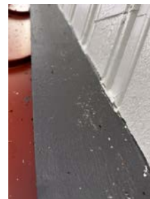
Vannbrett i overgang tilbygg og hovedhus som ligger utpå kledning med tettemasse.
