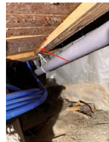
Bilde tatt inn i krypkjeller fra luken. Mulig fuktighet på bjelke?
