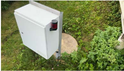
Renseanlegg under baken med tilkoblet EI-skap
