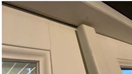
Det er påvist utetthet mellom dørblad og dørkarm
