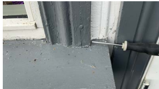
Råte i list
