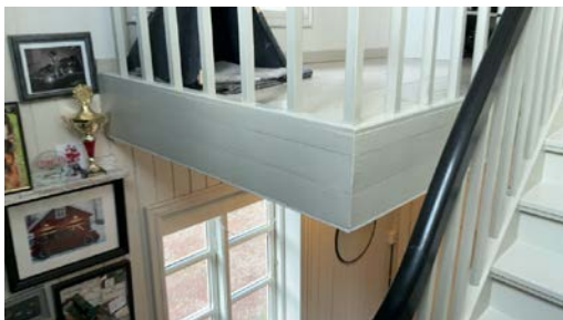
Manglende søyle under etasjeskille
