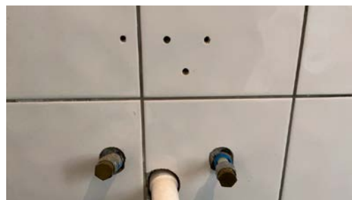
Det er registrert utette rørgjennomføringer i vegg
