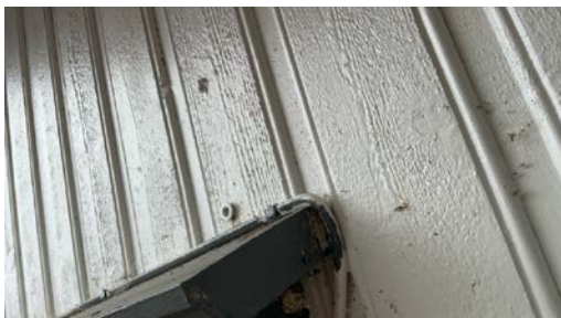
Vannbrett rett utenpå kledning
