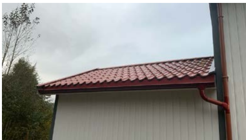
Det mangler snøfangere på tilbygg.
