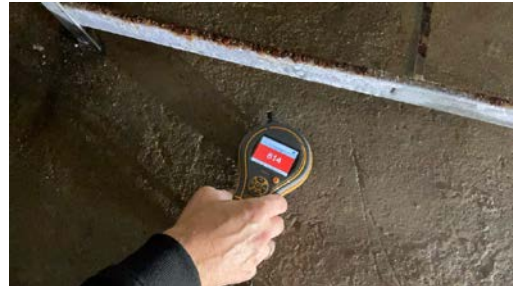
Fuktutslag på kjellergulv
