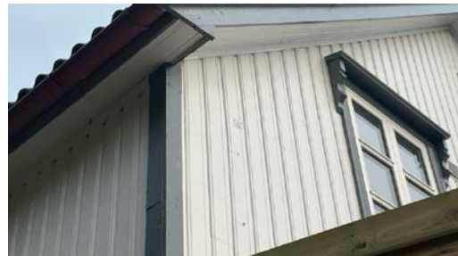
Oppsprekket hjørnekasse og hull som er tettet med tetningsmasse.
