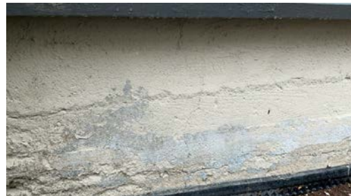
Riss i mur
