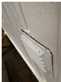
Ventil som ikke ligger inntil kledning
