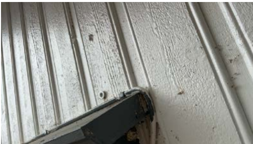
Vannbrett rett utenpå kledning
