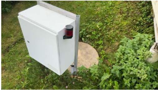
Rensanlegg under baken med tilkoblet EI-skap
