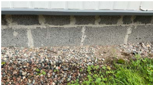
Lecablokker bør pusses
