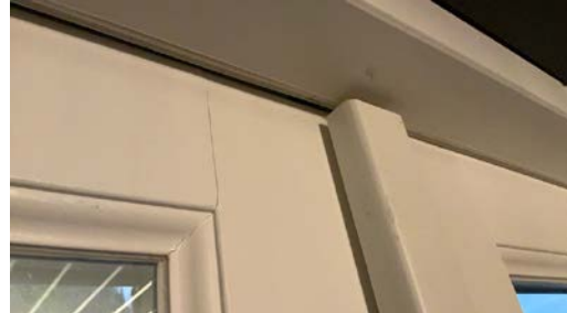
Det er påvist utetthet mellom dørblad og dørkarm
