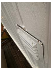
Ventil som ikke ligger inntil kledning
