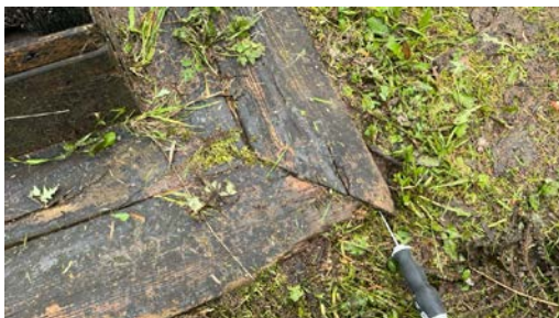
Eksempel på slitasje.
