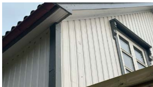
Oppsprekt hjørnekasse og hull som er tettet med tetningsmasse.
