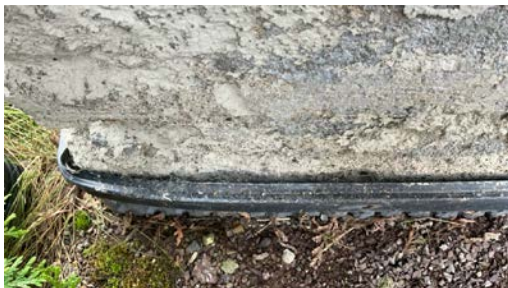
Løs list og mangelfull tetting
