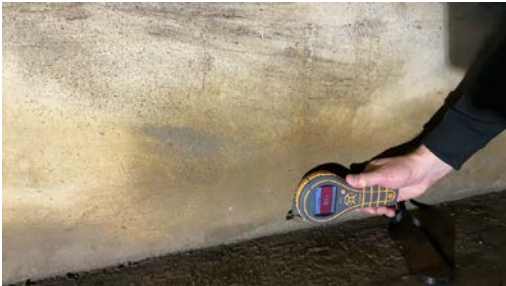
Fuktutslag på betongvegg
