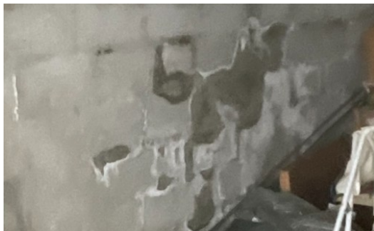
Fukt innsig i garasje
