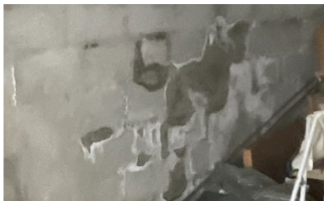
Fukt innsig i garasje
