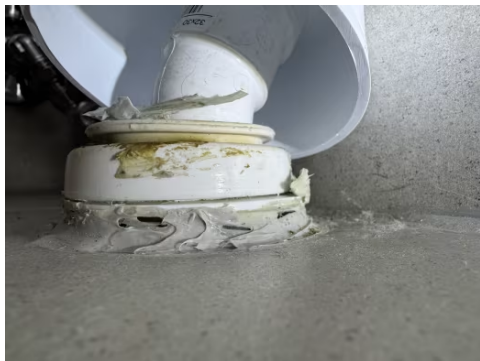
Rørføring under servant.
