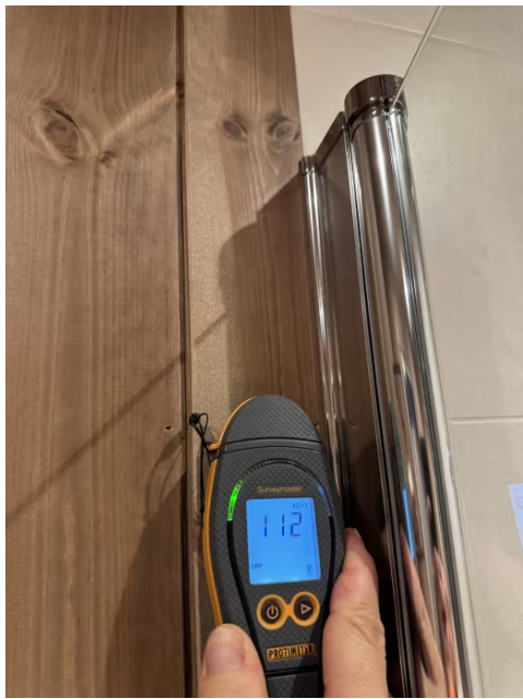
Panel i våtsonen men ingen fuktvariabler.
