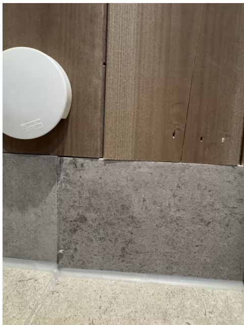
Mindre avvik på venstre side av dør.
