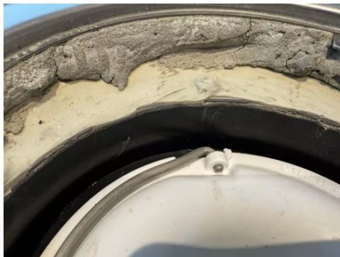
Synlig tettesjikt i sluk.
