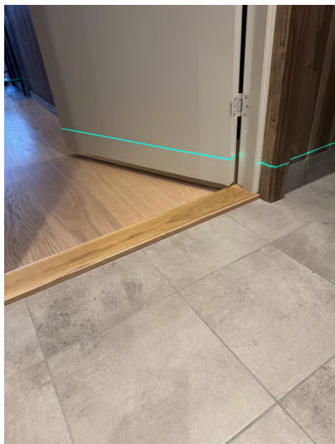
Ingen synlig oppkant av membran på dørterskel, men entreprenør bekrefter at det er oppbrett av membran på 15mm.
