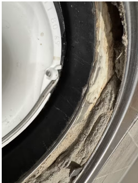
Synlig tettesjikt i sluk.
