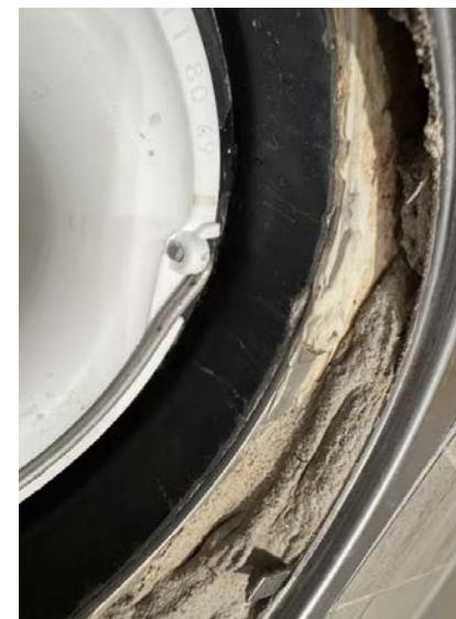
Synlig tettesjikt i sluk.
