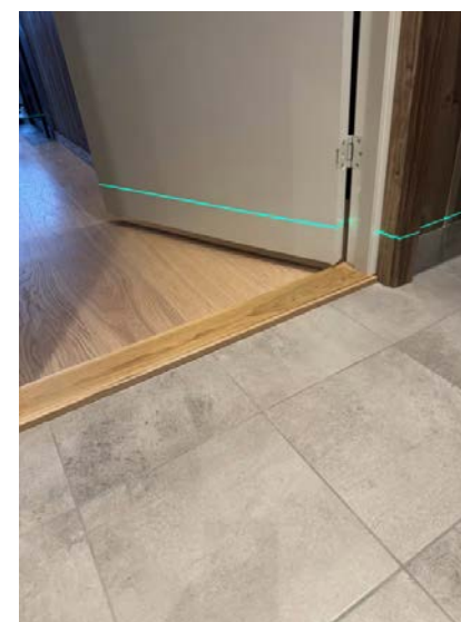
Ingen synlig oppkant av membran på dørterskel, men entreprenør bekrefter at det er oppbrett av membran på 15mm.
