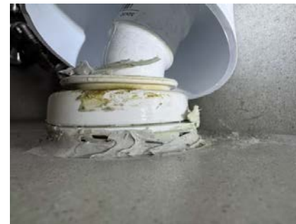
Rørføring under servant.
