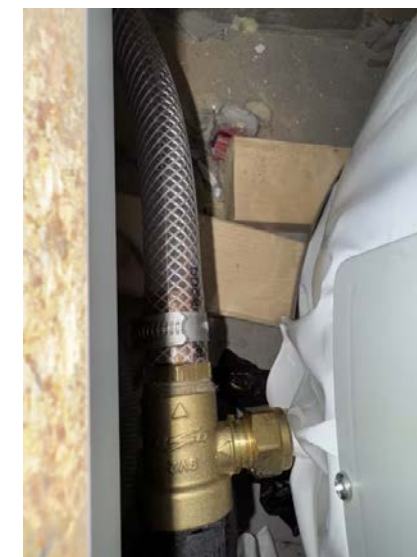
Det er påmontert slange fra sikkerhetsventil til avløp.
