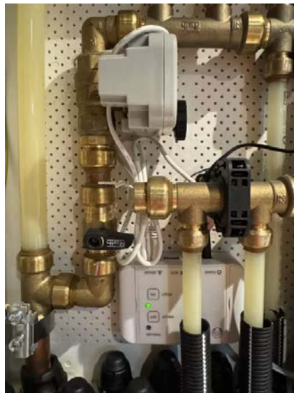
Stoppekran og lekkasjesikring.
