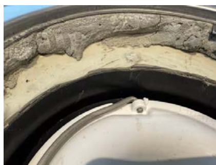
Synlig tettesjikt i sluk.
