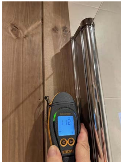
Panel i våtsonen men ingen fuktvariabler.
