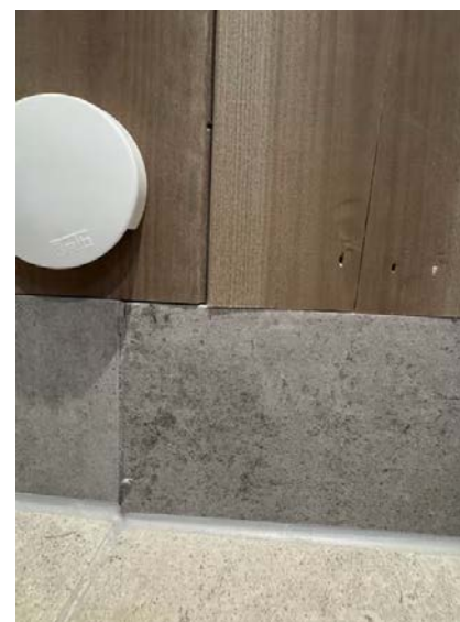
Mindre avvik på venstre side av dør.
