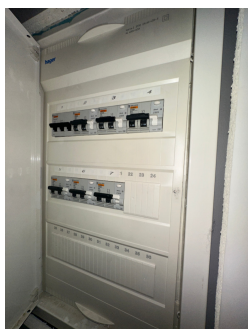
Sikringsskap med automatsikringer.
