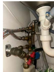
Røropplegg i kjøkkenbenk med Waterguard
