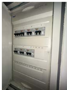
Sikringsskap med automatsikringer.
