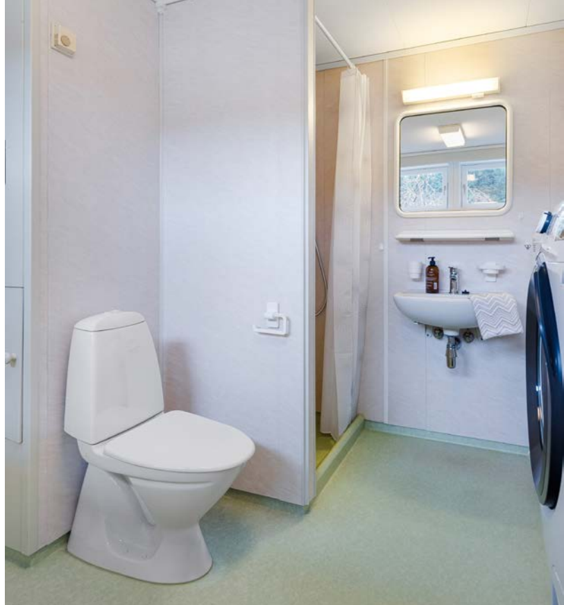
Badet/vaskerom er innredet med dusjnisse, servant, bereder, overskap og vannuttak for vaskemaskin.
