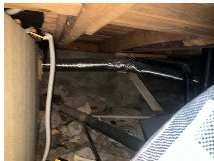
Mangler isolasjon mot badegulvet.
