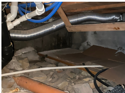
Fukt i hjørnet av kryperommet.
