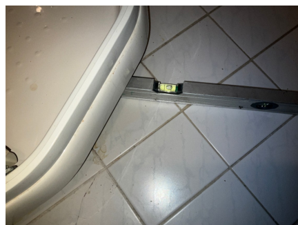
Flere sprekker i gulvet.
