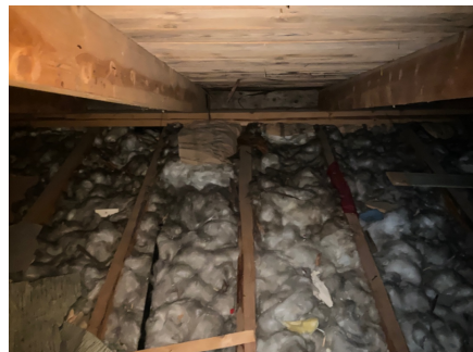
Utettheter i innvendig fuktsperre.
