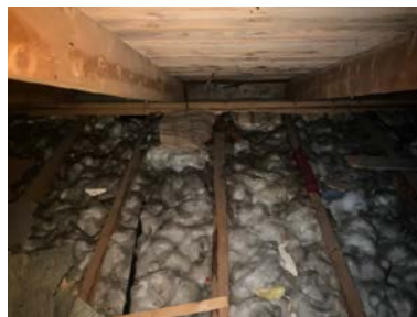
Utettheter i innvendig fuktsperre.
