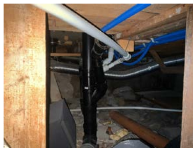
Sorte rør av nyere dato, grå rør eldre dato.
