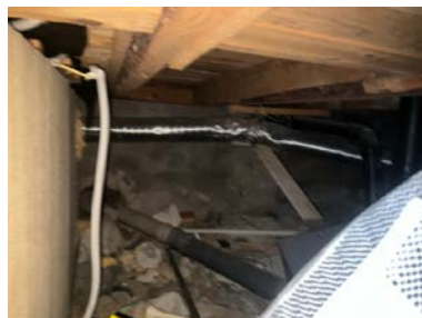
Mangler isolasjon mot badegulvet.
