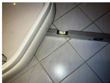
Flere sprekker i gulvet.
