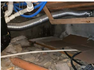
Fukt i hjørnet av kryperommet.
