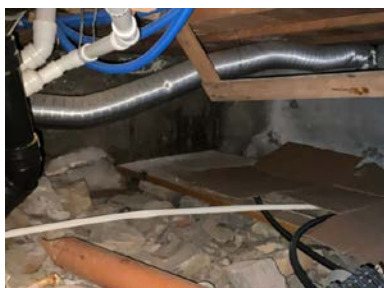
Fukt i hjørnet av kryperommet.
