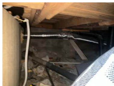
Mangler isolasjon mot badegulvet.
