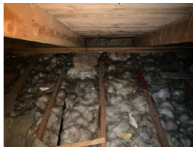
Utettheter i innvendig fuktsperre.
