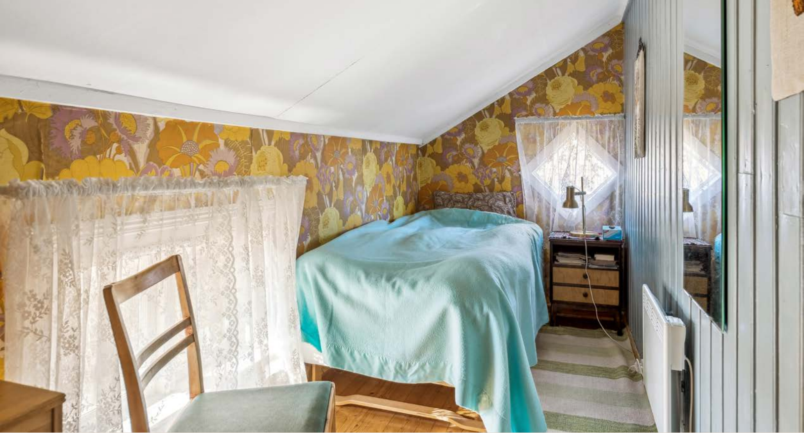
Kott brukt til soverom. Rommet tilfredsstiller ikke dagens krav til beboelsesrom
