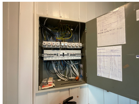
Sikringsskap i felles trappegang
