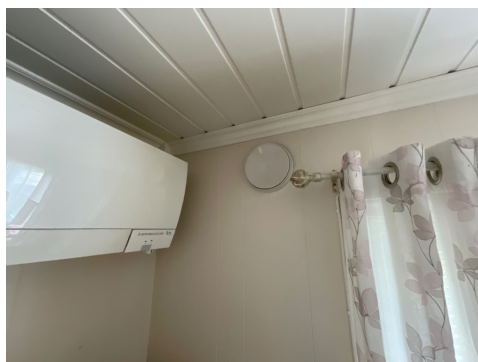
Lufterventil i stuen
