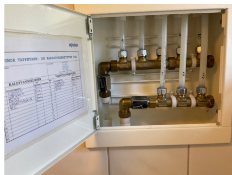
Rør i rør skap på baderom
