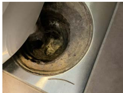
Sluk på baderom
