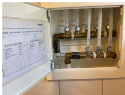
Rør i rør skap på baderom
