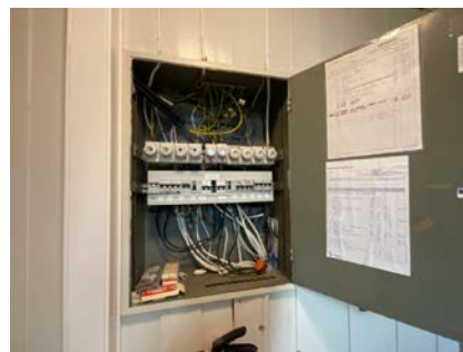
Sikringsskap i felles trappegang
