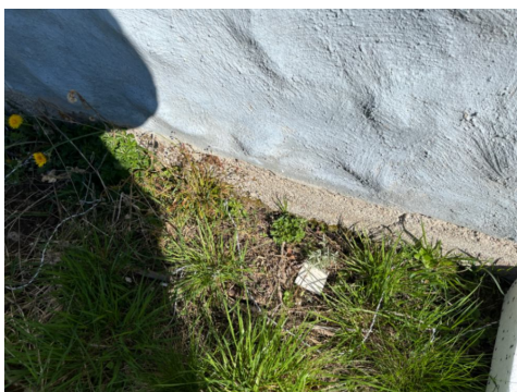
Ingen fuktsikring utvendig på grunnmur
