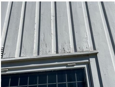
Råteskader i kledning
