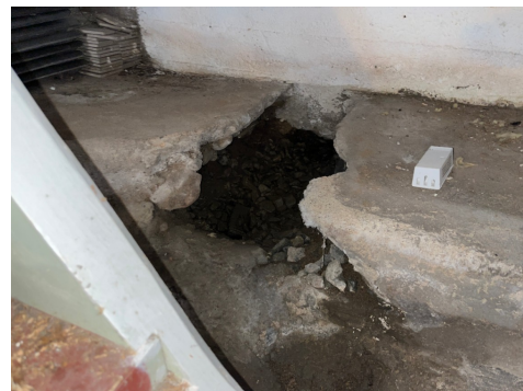
Synlig vann i kjeller.
