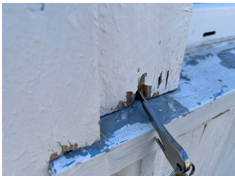
Råteskader i kledning
