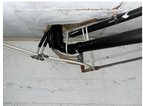
Røranlegg i kjeller
