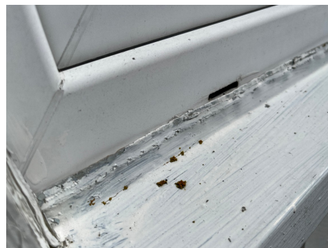
Beslag ligger mot vindu. Åpent bak beslag.
