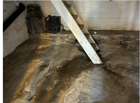
Synlig vann på fjell i kjeller
