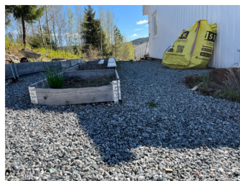
Terreng med noe fall mot grunnmur
