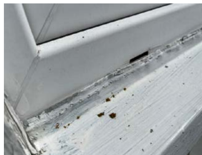
Beslag ligger mot vindu. Åpent bak beslag.
