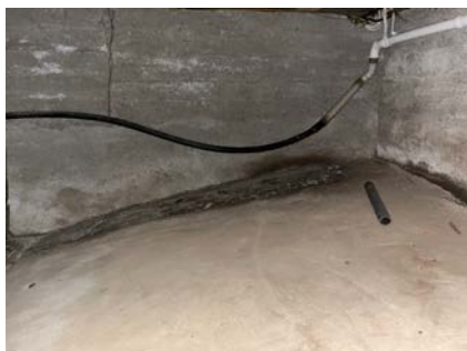
Avløpsrør fra kjøkken
