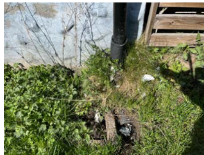
Takvann går rett ut på grunn ved grunnmur
