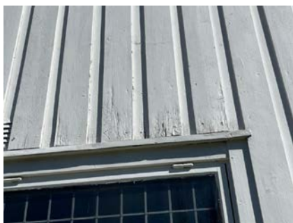
Råteskader i kledning
