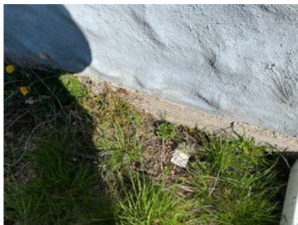
Ingen fuktsikring utvendig på grunnmur
