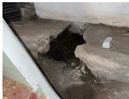
Synlig vann i kjeller.
