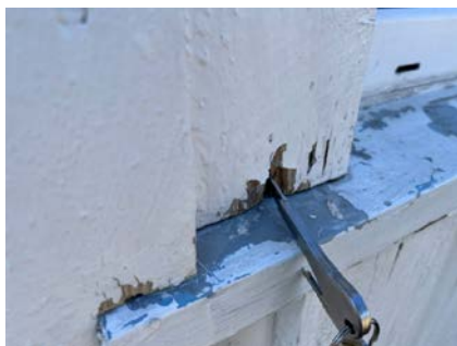
Råteskader i kledning
