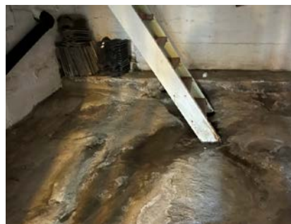
Synlig vann på fjell i kjeller
