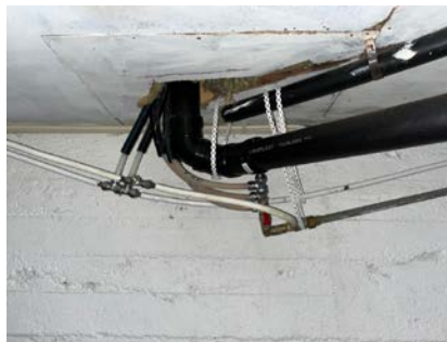
Røranlegg i kjeller
