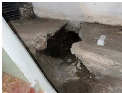
Synlig vann i kjeller.
