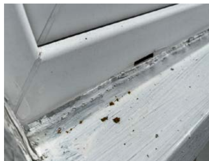
Beslag ligger mot vindu. Åpent bak beslag.
