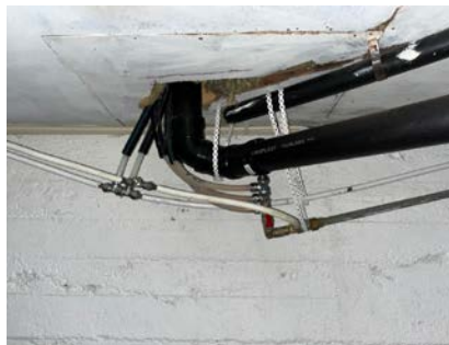
Røranlegg i kjeller
