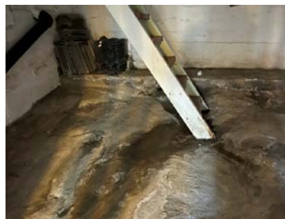
Synlig vann på fjell i kjeller
