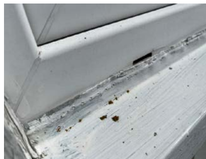
Beslag ligger mot vindu. Åpent bak beslag.
