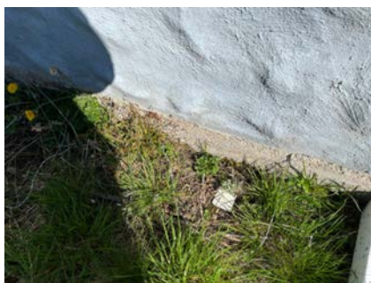
Ingen fuktsikring utvendig på grunnmur
