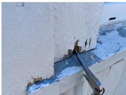
Råteskader i kledning
