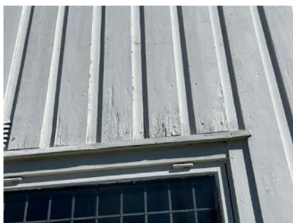
Råteskader i kledning
