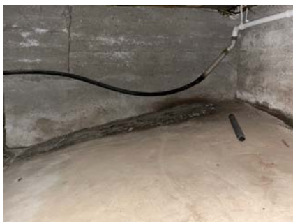
Avløpsrør fra kjøkken
