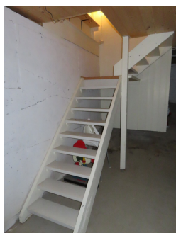
Enklere plassbygd trapp mellom kjellerplan og 1.etg. Det ses å mangle rekkverk og håndløper.
