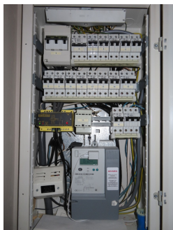
Sikringsskap med automater fra byggeår.
