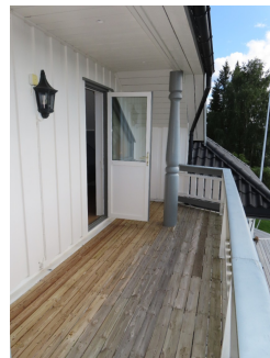
Del av veranda i 2.etg ut for stue/soverom etter nedre side. Dør fra stue - adkomst videre til terreng. Merk lavere rekkverk i forhold til dagens krav.
