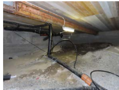
Del av åpent etablert avløpsrør.
