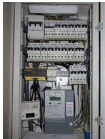
Sikringsskap med automater fra byggeår.
