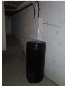
Nyere 200 liters varmtvannsbereider samt samleskap for trykksatte rørføringer på deler av anlegget.
