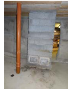
Sotluke i kjeller på pipe i kjøkken/spisestuedel.
